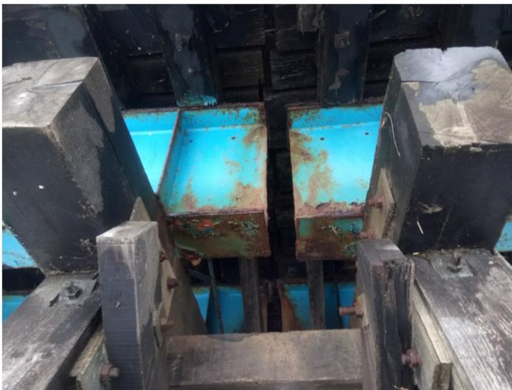
Slika 2.17 Vidno vlažne naglavne grede na stupištu 5 i gornji ustroj iznad čeličnih nosača. Korozija čeličnih nosača i spojnih sredstava na spoju naglavne grede i stupova.
