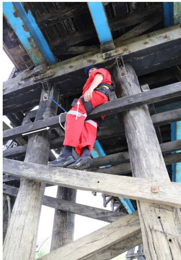
Slika 17. Mjerno mjesto 2 na II stupištu. Marín na zadatku. Strelicama su označeni izvrci iz glave stupa i naglavne grede. Gornji dio jarma je u naoko dobrom stanju, okov je zatezan u bjeljici do srčevine, zaostatak izvorne zaštitne boje pokazuje da površina nije zaražena i erodirala kao doljnji dijelovi stupišta.
