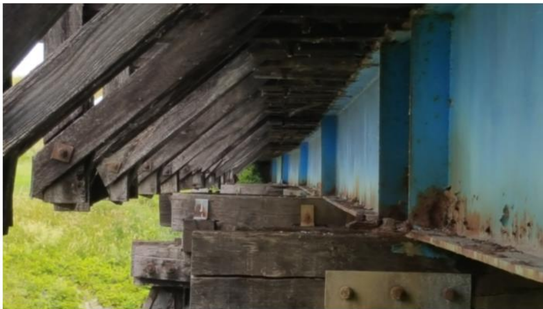
Slika 2.28 Horizontalna poprečna deformacija mosta vidljiva na glavnim čeličnim nosačima – pogled Rakitovec - Kuče
