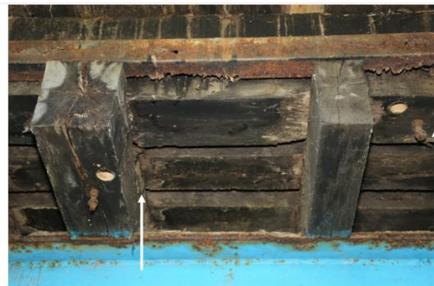
Slika 43. Pogled na kolničku nosivu konstrukciju na mjernom mjestu 6 (označeni su izvrci iz praga i iz mosnice izvan čeličnih nosača). Poprečne grede (pragovi) su različitih dimenzija i stanja, kraći pragovi su većinom samo površinski zaraženi. Manji dio pragova s uklopjenim srcem (lijevo) pokazuje obojenje od čelne zaraze truležnicama i veće pukotine. Treći izvrtak izuzet je iz mosnice između čeličnih nosača
