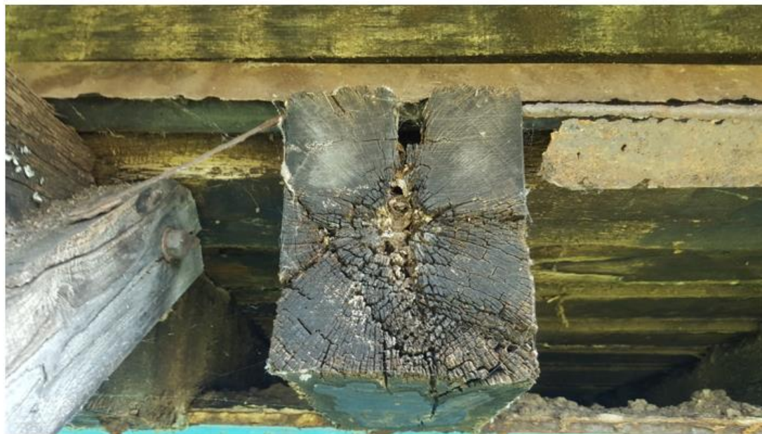
Slika 2.20 Poprečni prag s nezaštićenim čeonim dijelom. Pukotine i truljenje drvenog materijala.
