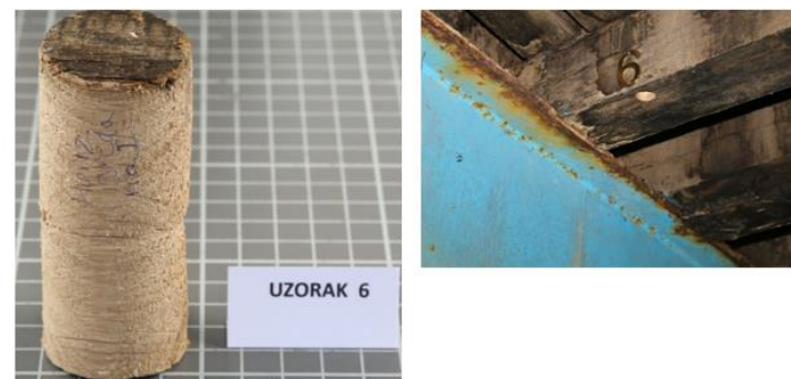
Slika 44. Izvrtak s mjernog mjesta MM 6, iz doljne zone praga (lijevo). Slični uzorci su izvađeni su i iz doljne strane mosnice i praga između čeličnih nosača (slika desno). Osim potrošene površine u dubini 3 - 5 mm, drvo naoko izgleda zdravo i konzistentno.
