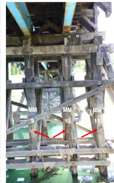
Slika 34. Stupište IV. Strelce pokazuju mjesta i smjer izvrtaka. Stupovi uz vodu su toliko propali da se na MM 10 i 11 ne mogu izvaditi konzistentni izvrci drva nego samo ostaci truleži
