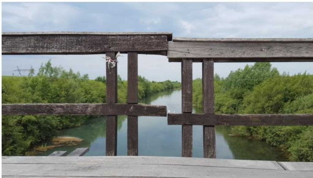
Slika 2.9 Vertikalna denivelacija ograde upućuje na značajno oštećenje i deformaciju nosivog dijela gornjeg ustroja
