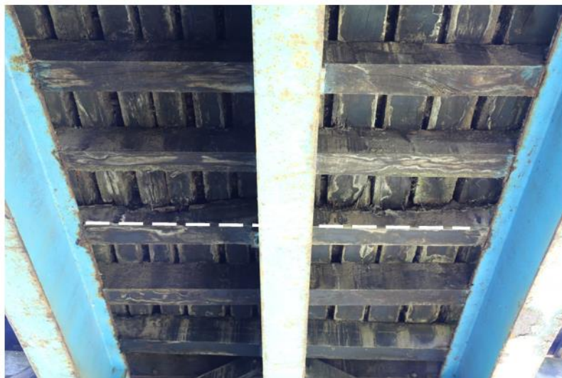
Slika 42. Pogled odozdo na nosivu kolničku konstrukciju. Vide se površinska oštećenja po bridovima pragova i mosnica, ali i izostanak velikih pukotina. Drvo je uglavnom vrlo dobre tehničke kvalitete prema vizualnom klasiranju po DIN 4074-5. Posebno je zaznačeno mjesto kraćega praga nad kojim su 12 cm debele uzdužne mosnice čelno slijubljene. U ovoj zoni voda zamače spojeve i prodire uzduž vlakanaca, drvo je mnogo mokrije pa je vidljiv i intenzivan razvoj truleži na gornjoj plohi praga i po cijelom presjeku mosnica. Ovakvi dijelovi se mogu lokalno izmjenjivati.
