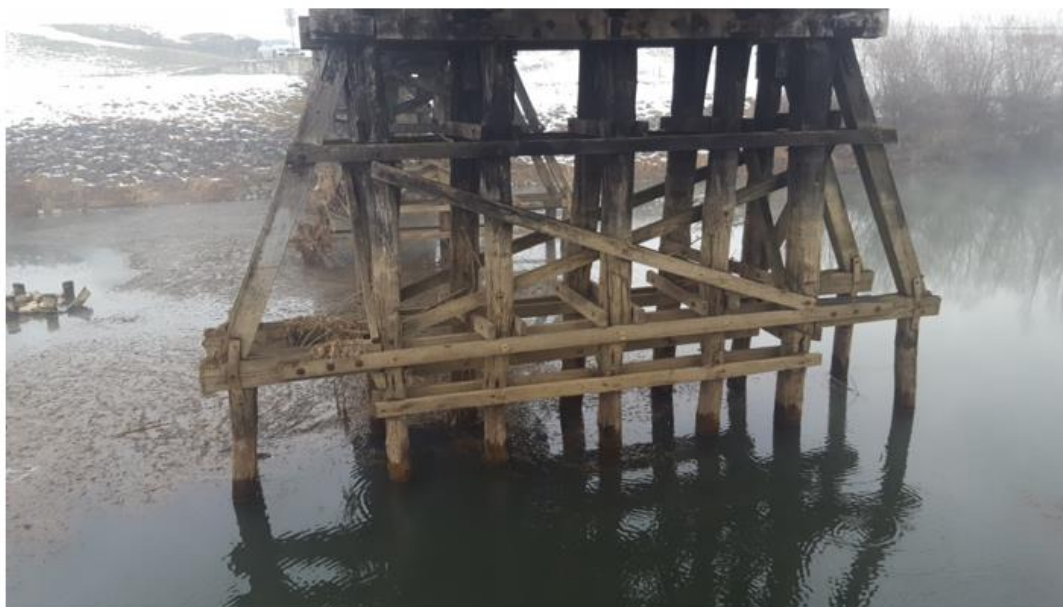
Slika 2.38 Stupište (jaram) 2 – vidljiv obilan prodor vlage kroz kolničku konstrukciju na donji ustroj mosta. Razlika u boji elemenata stupišta u gornjoj polovici i donjoj polovici gledajući od vodnog lica do gornje ustroja mosta.
