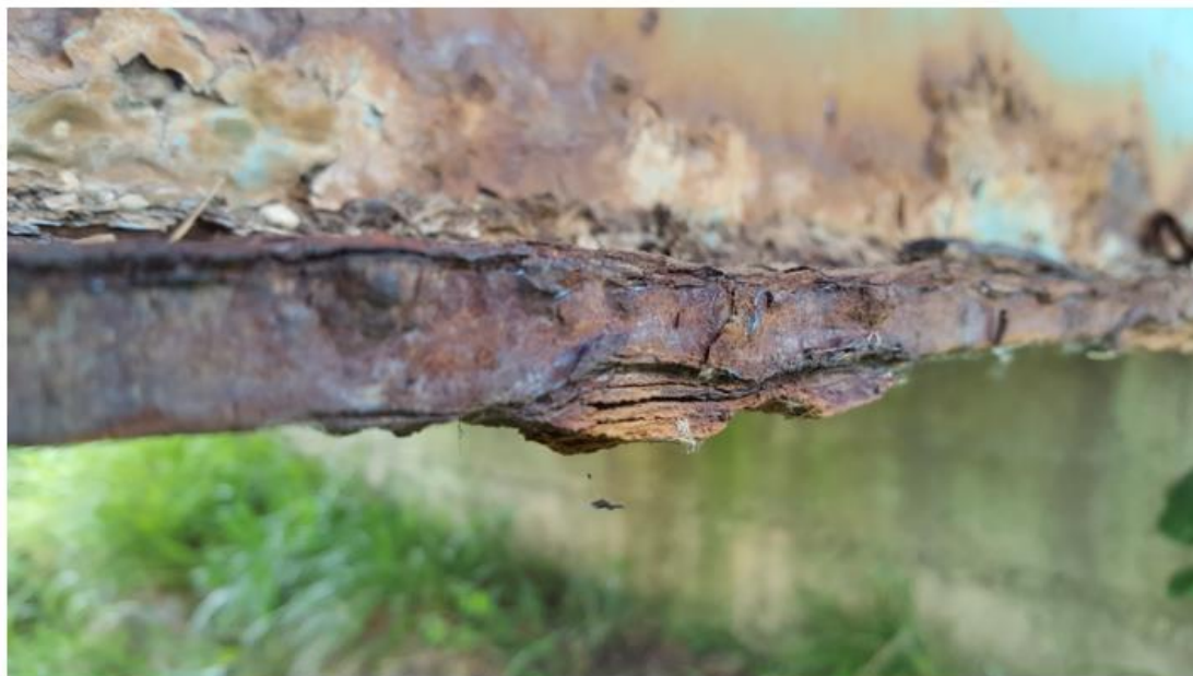
Slika 2.22 Raslojavanje i otpadanje dijelova pojasnice i rubnih dijelova hrpta na čeličnim nosačima. Redukcija nosivog poprečnog presjeka.
