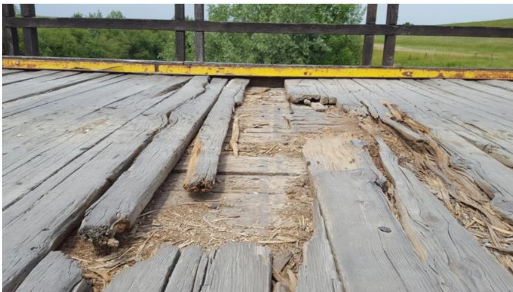
Slika 2.6 Ispucale mosnice po cijelom presjeku i uzduž iste . Nedostaju veliki dijelovi posljednjeg sloja kolničke konstrukcije.
